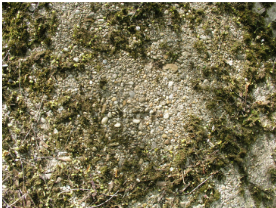
to. č. 3 Detail obnaženého betónu kopúl – porušený betón vplyvom pôsobenia atmosféry
