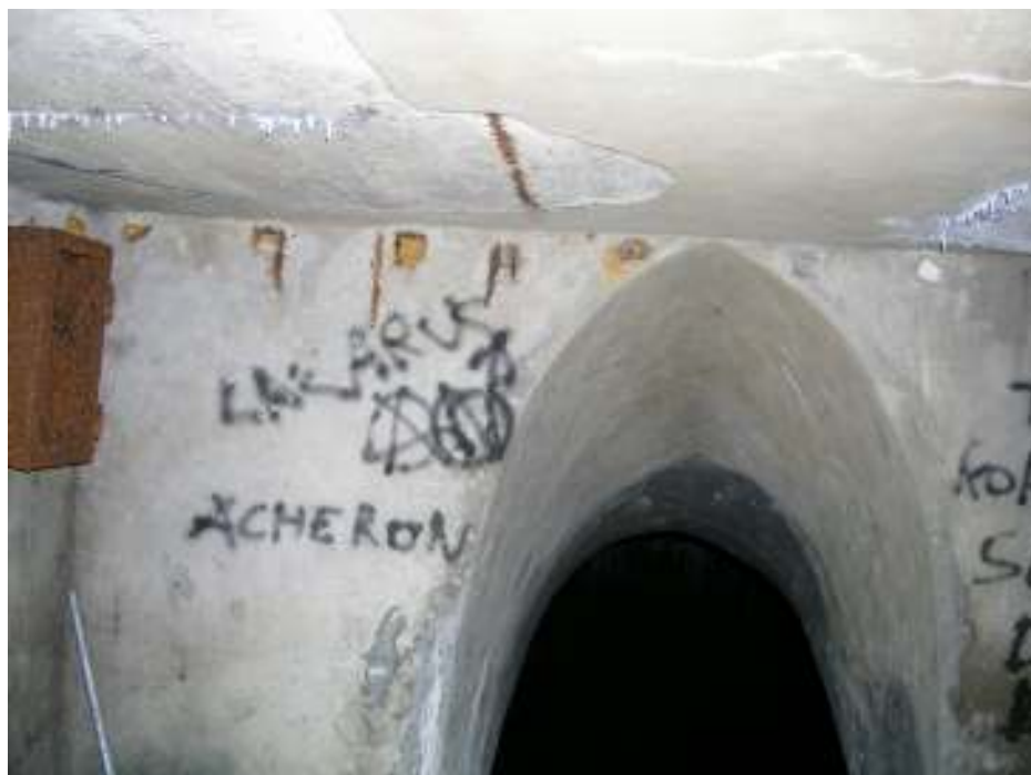
foto. č. 6 Strop manipulačnej komory a vstup. otvor do akum. nádrže – obnažená a skorodovaná výstuž, kvaple v trhlinách – korózia betónu
