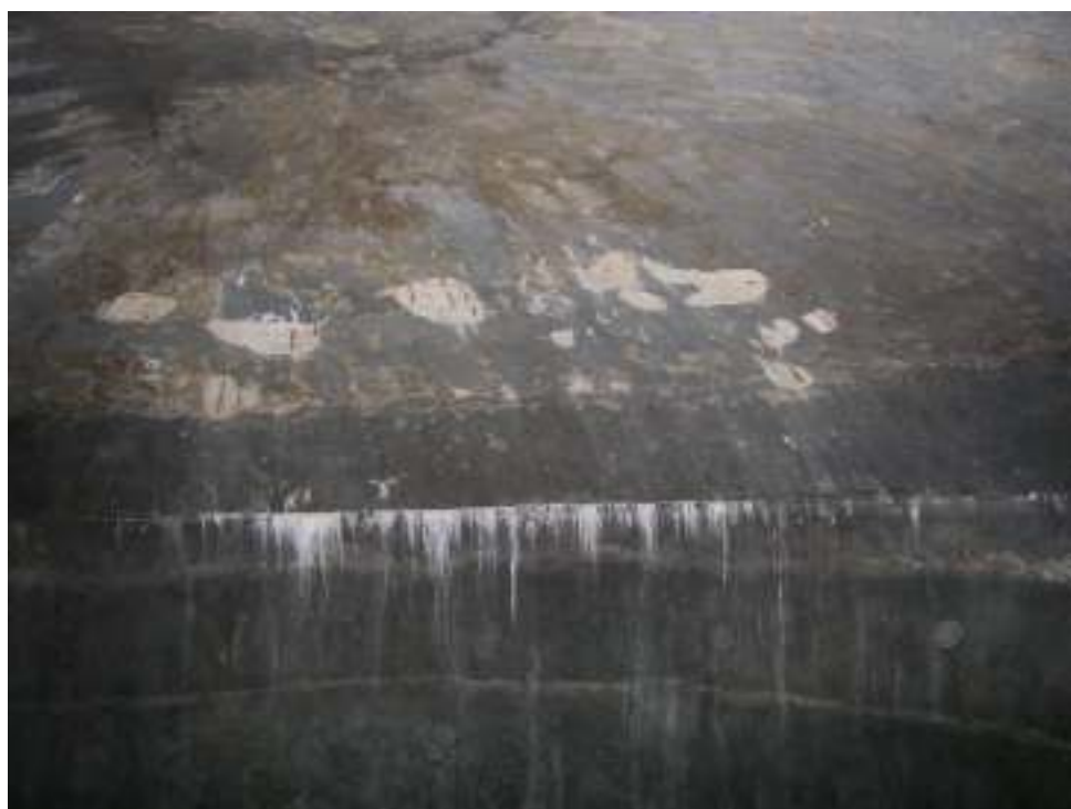
foto. č. 10 Pohľad do akumuláčnej nádrže – kopula a stena obnažená a skorodovaná výstuž, potečenie v trhlinách – korózia betónu
