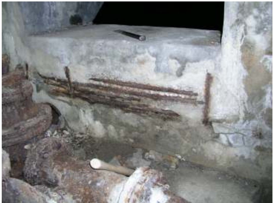
foto. č. 8 Obnažená a značne skorodovaná výstuž stuhujúceho venca
