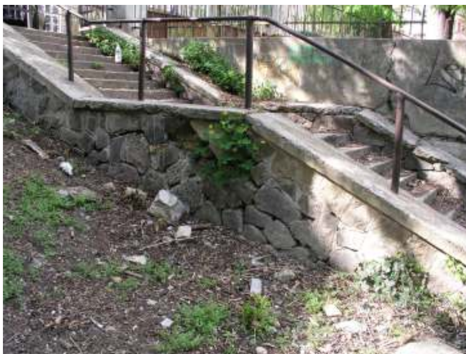
foto. č.12 Poškodené kamenné múry schodou a trhlina v betónovom opornom múre
