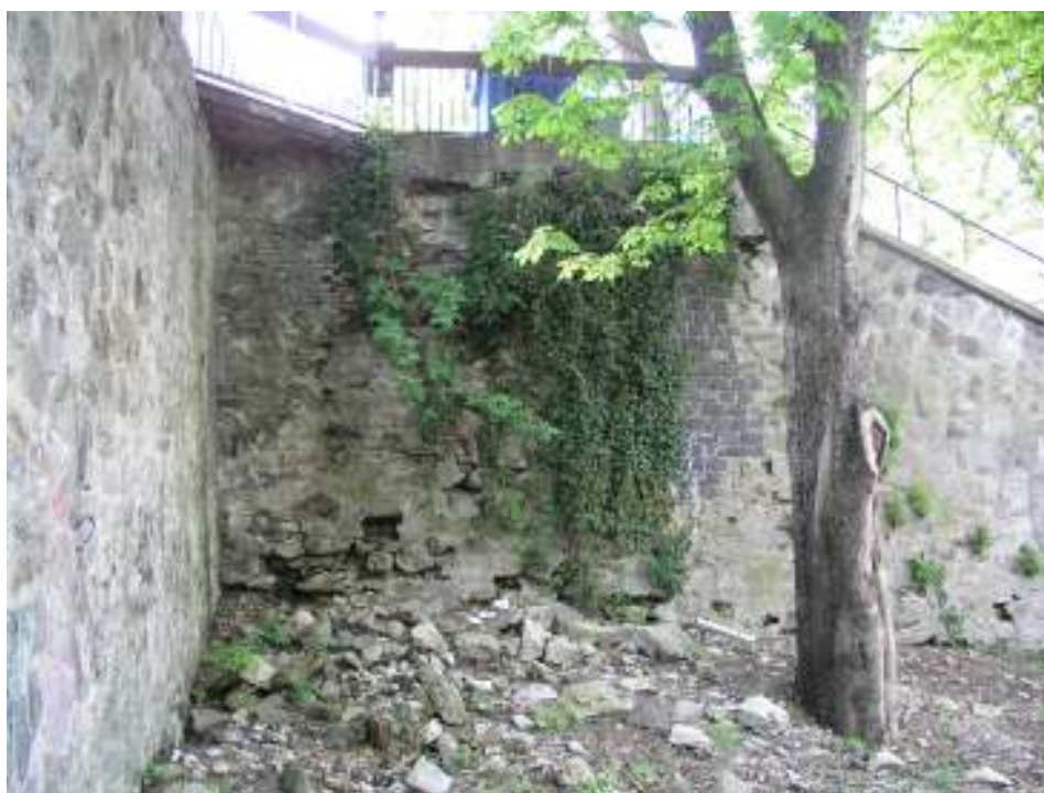
foto. č.11 Značne poškodený vysoký kamenný múr, kamene z múru povypadávajú
