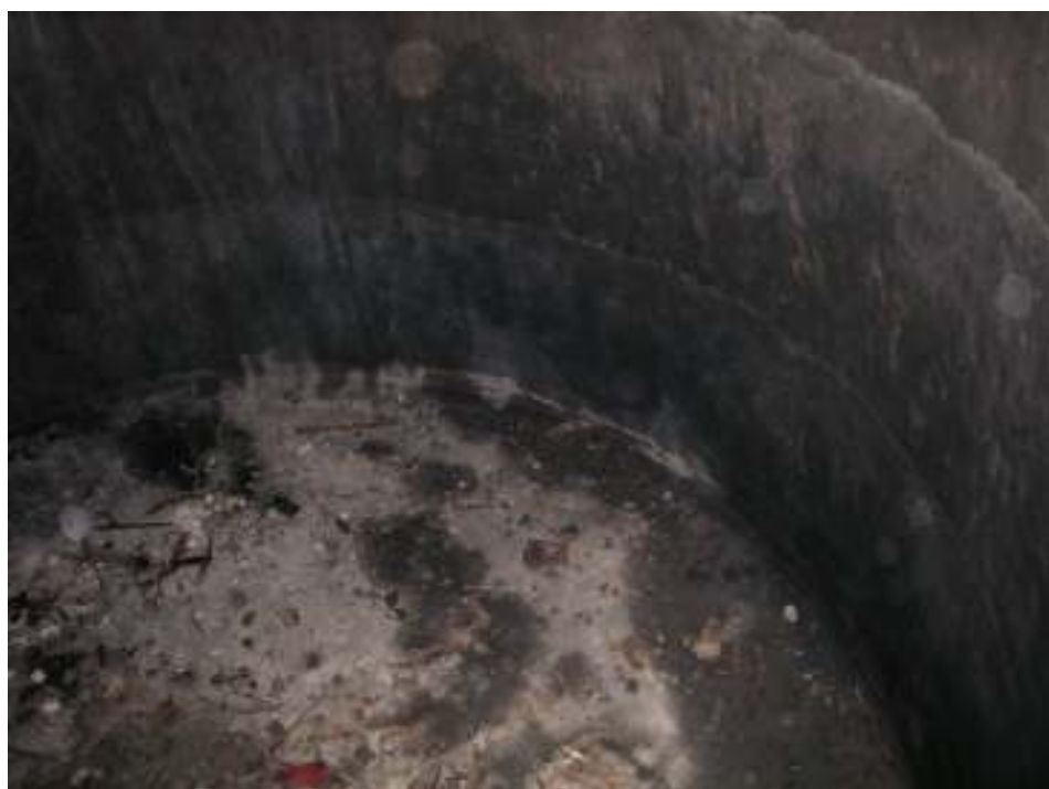
foto. č. 9 Pohľad do akumuláčnej nádrže - dno a stena, vodorovné trhlinky v mieste pracovných škár
